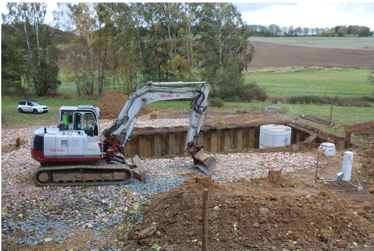
Pasečnice – stavba ČOV v těchto místech porušila novověký zahloubený výrobní objekt
